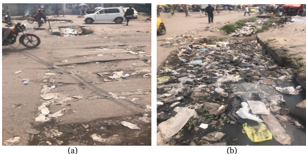
Photo 4.6. État des caniveaux sur le triangle Kabambare-huilerie dans le quartier Mongala
