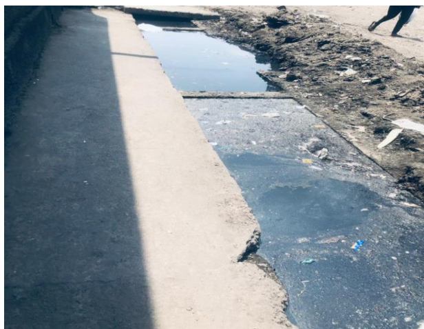
Photo 4.5. État des caniveaux sur l'avenue Usoki dans le quartier Ngwaka
